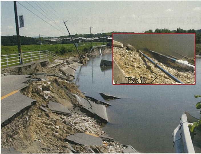
農業集落排水施設 (伊賀市 国道 422 号)
