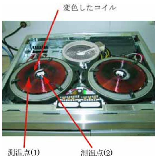
図3 コイルの変色状況および熱電対の測温点
