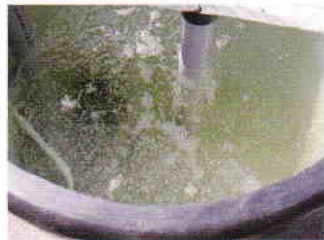
オゾンガスの気泡 排オゾン処理が必要
