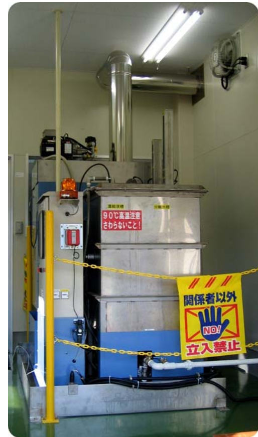
廃液蒸発装置
