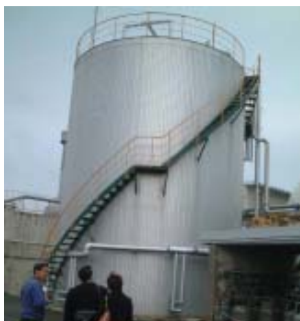
バイオガス化施設 (メタン発酵槽)
