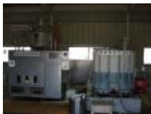
いなべ市プラント
