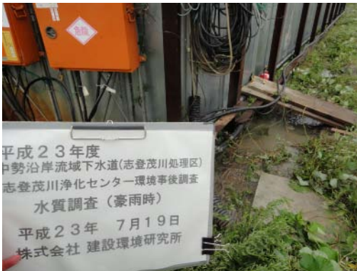
写真9 湛水状況 (7月19日調査)
