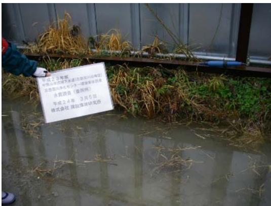
写真 13 湛水状況（3月5日調査）
