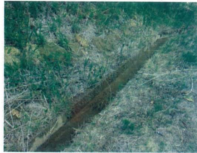
21. 山口池漏水状況
