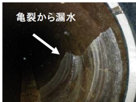
用水管の漏水
