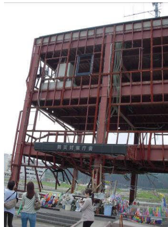
南三陸町防災対策庁舎
