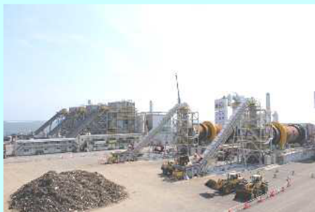
石巻ブロックの仮設炉（5基） （H24.9.24からフル稼働開始）
