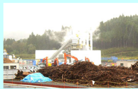
気仙沼ブロック南三陸処理区の仮設炉 （3基）（H24.9.15試運転開始）
