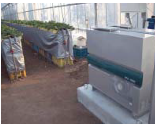
燃料電池実証試験の状況
