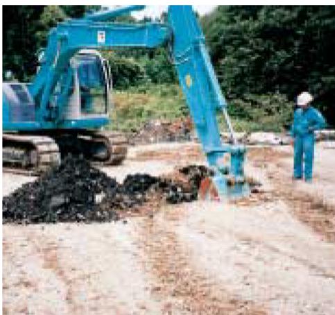
3 覆土で覆い隠された不法投棄現場
