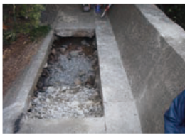
空洞化した堤防の内部
