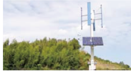
小型風力発電装置(伊勢市生涯学習センター)
