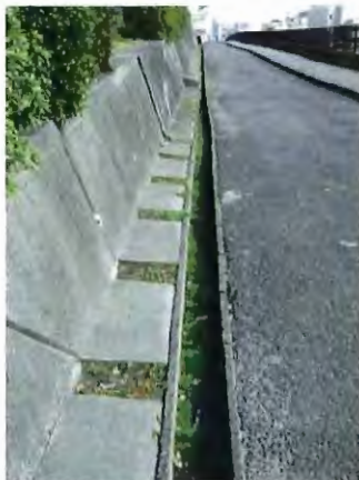
溝に土がたまり草が生えている。
