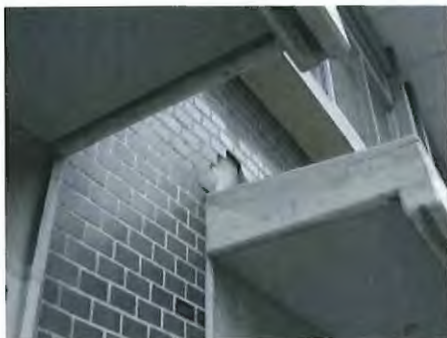
タイルが浮いて、剥落している。
