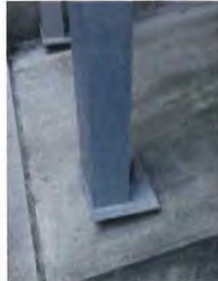
支柱(躯体への接合部)のボルトが緩んでいる。
