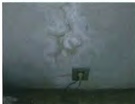
壁に水浸みの跡がある。(漏電の危険性あり)
