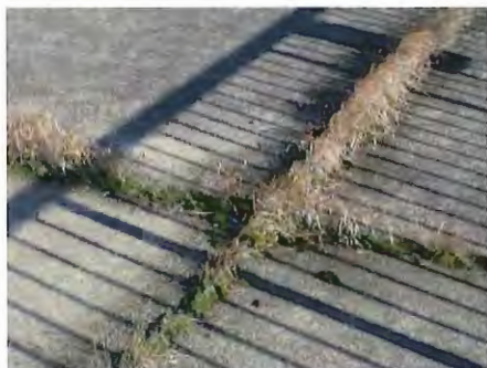
コンクリート目地に草が生えている。
