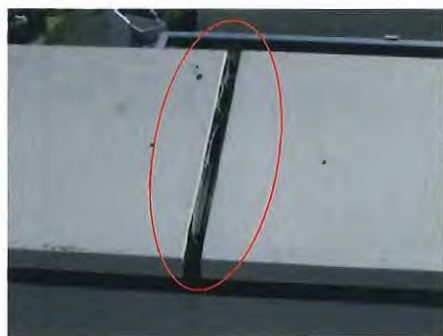
外装パネル目地のシーリング材がひび割れている。
