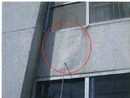
吹き付け材が浮いて、膨らんでいる。
