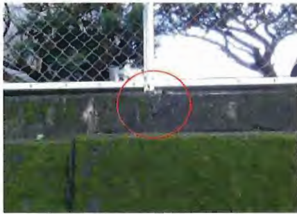
フェンスの根元のコンクリート が割れている。
