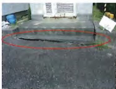
地盤が下り、階段とアスファルトの間に隙間が開いている。
