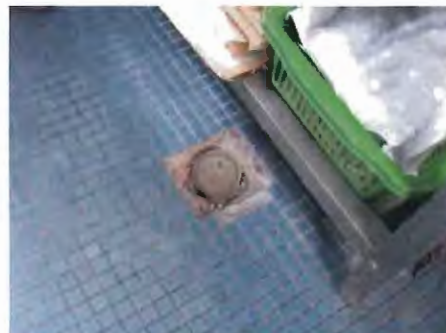
配管口周りの床タイルが剥がれている。
