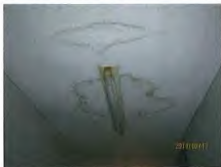
天井に水漏れのしみがある。
