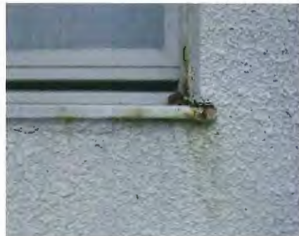
スチール窓枠が錆びている。
