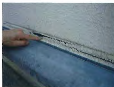
コンクリートと金属板の間を埋めるシーリング材がひび割れている。
