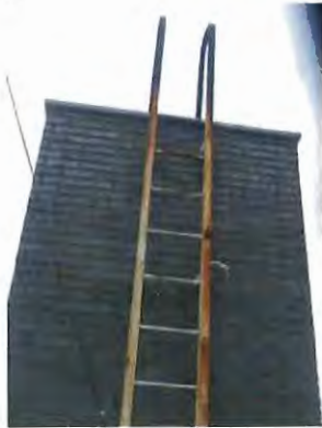
はしごが錆びている。
