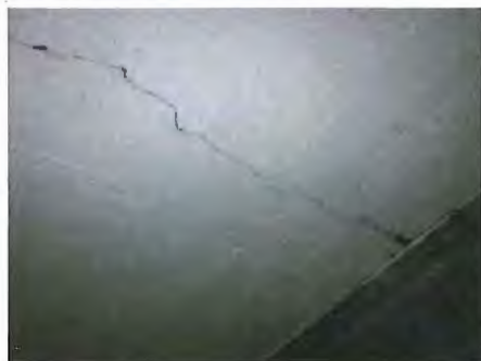
天井がひび割れている。
