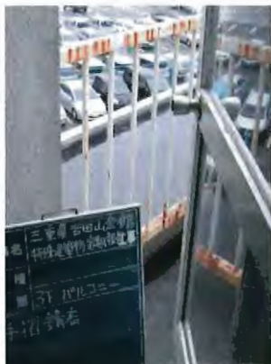
手すりが錆びている。
