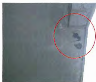
吹き付け材が剥がれている。
