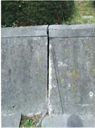
擁壁の継目に隙間が開いている。
