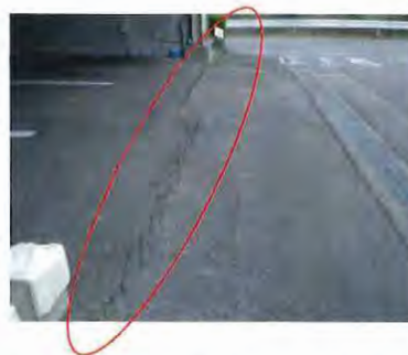
地盤が下り、建物との境目でひび割れている。
