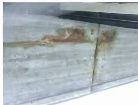
モルタルが割れて、錆汁が出ている。
