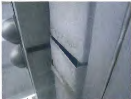
樋の継目が外れている。
