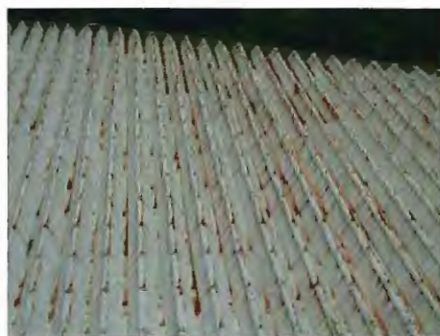
屋根葺き材が錆びている。
