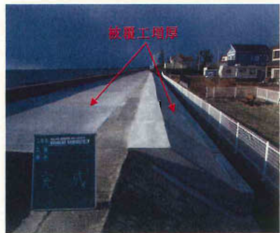
南若松地区海岸（鈴鹿市南若松町） 平成 24 年度老朽化対策完了箇所
