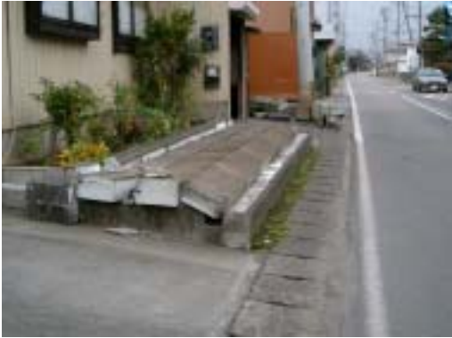
ブロック塀の被害状況
