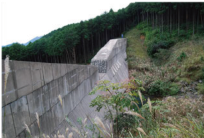
①堰堤背面状況
