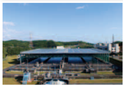
播磨浄水場太陽光発電設備 (水道事業室)
