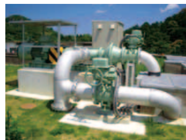
磯部浄水場小水力発電設備
