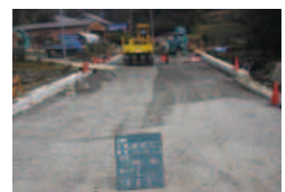
再生砕石(RC-40)を 路盤材として利用 伊賀建設事務所(伊賀市)
