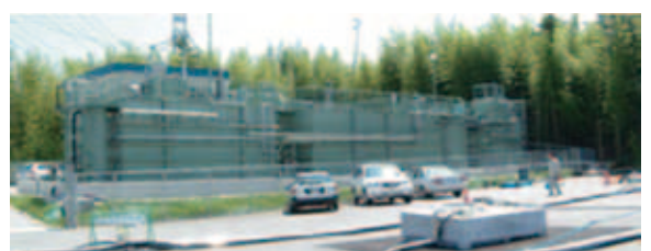
行政代執行による支障等の除去 （有害な産業廃棄物による汚染地下水の浄化施設）
