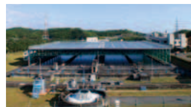
播磨浄水場太陽光発電設備（桑名市）
