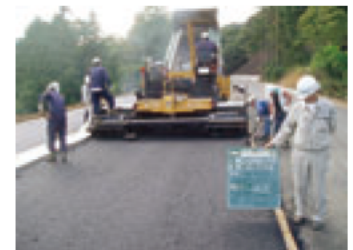
再生アスファルトを用いた道路舗装 伊勢建設事務所（南伊勢町）
