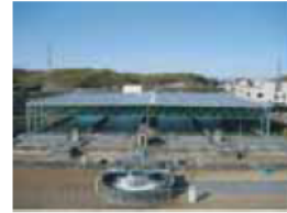
播磨浄水場太陽光発電設備(桑名市)
