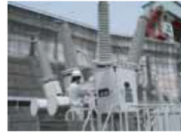
変電設備の点検 (三瀬谷ダム・大台町)
