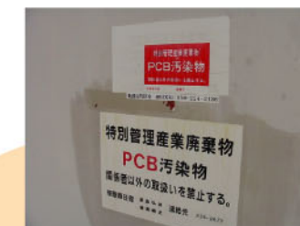
PCB保管庫表示(総務局管財室)
