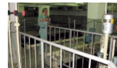
合併処理施設(浄化槽)の処理水が適正状態であるか測定しています。(本庁)
