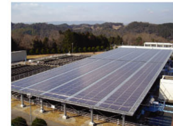
高野浄水場の太陽光パネル
