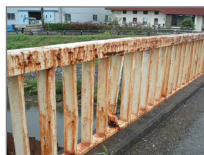
< 高欄の腐食(橋梁) >
