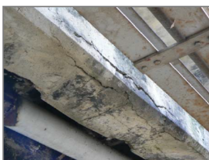
< ひび割れの様子(橋梁) >
