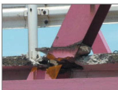
< 破断の様子(橋梁) >
