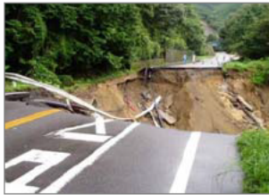
＜台風により路面陥没した 国道42号(H16)＞
