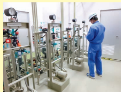
薬品注入設備の定期点検
