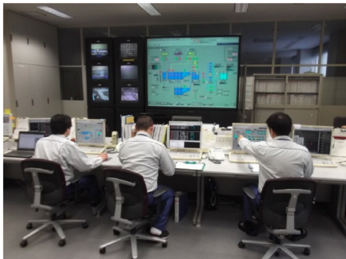
北勢水道中央監視室からの統括運転監視
