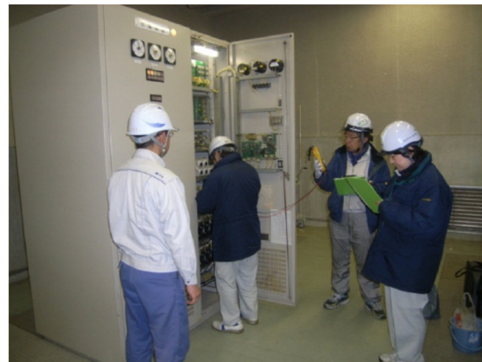
電気設備点検
