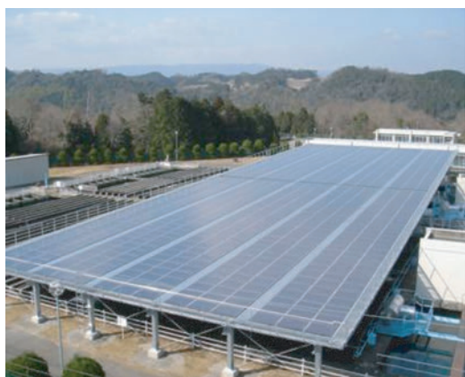
太陽光発電（高野浄水場）
