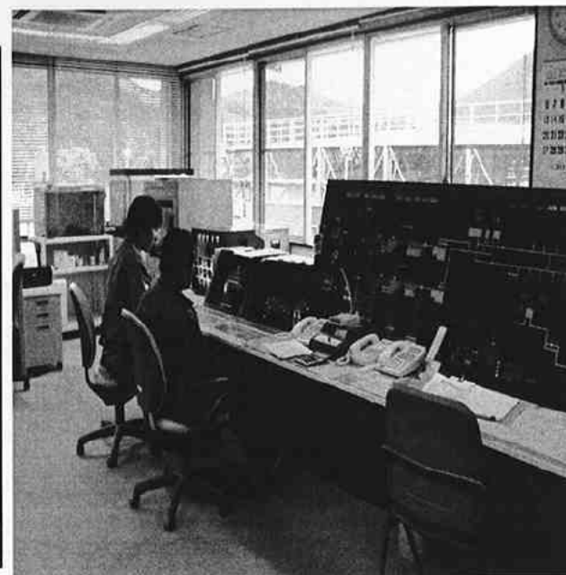
浄水場の中央監視制御装置
