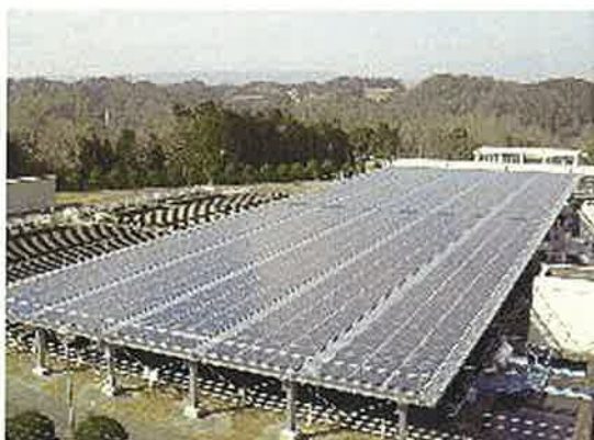
【太陽光発電設備（高野浄水場）】
