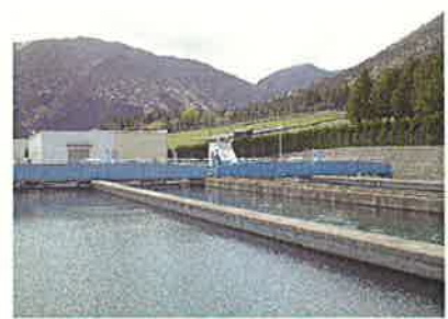
沈でん池（北中勢水道 水沢浄水場）
