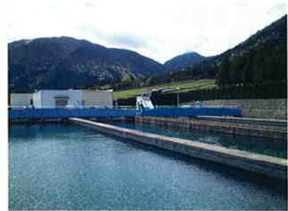
沈でん池(北中勢水道 水沢浄水場)
