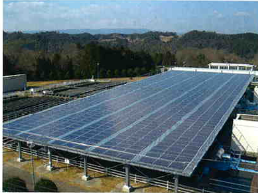
太陽光発電設備(高野浄水場)
