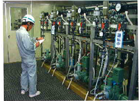
薬品注入設備の定期点検
