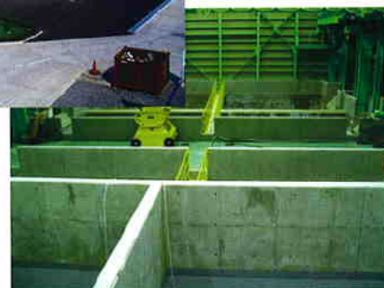
RDF貯蔵ピット
