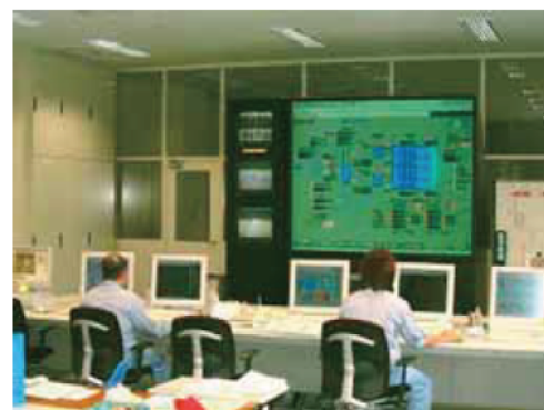
民間業者による運転監視
