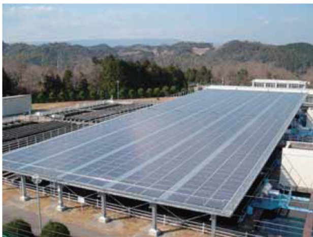
太陽光発電施設(高野浄水場)
