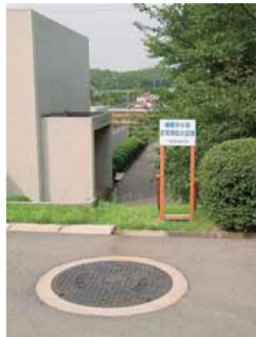
震災時の応急給水拠点
