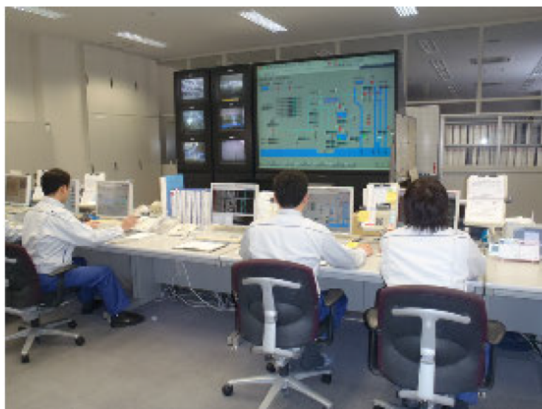
北勢水道事務所中央監視室からの統括監視
