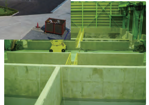
RDF貯蔵ピット
