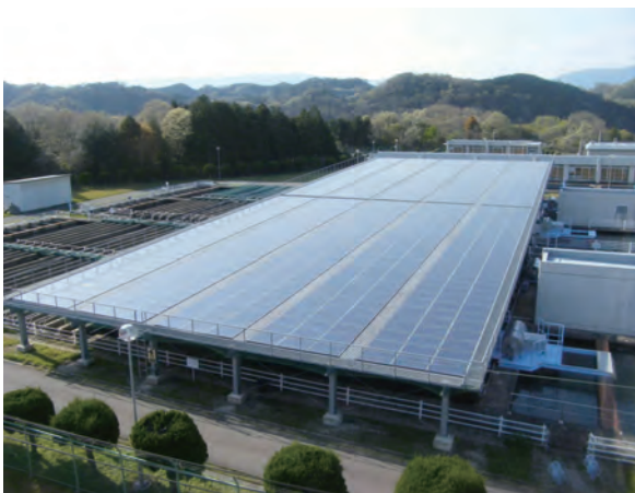
【太陽光発電設備(高野浄水場)】
