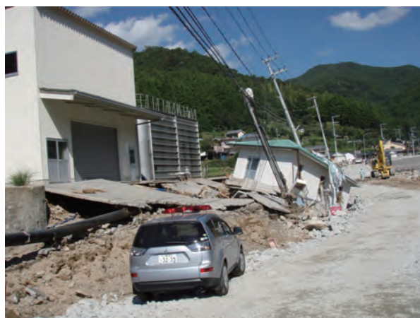
【浄水施設の被災状況(熊野市)】
