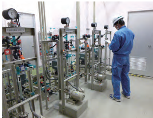
薬品注入設備の点検
