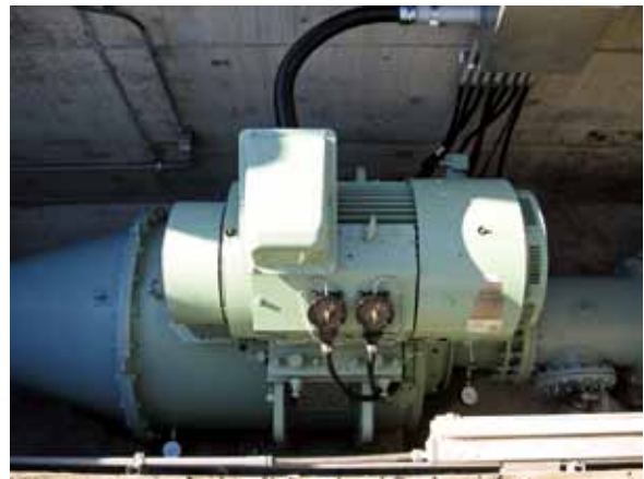
【小水力発電設備】
