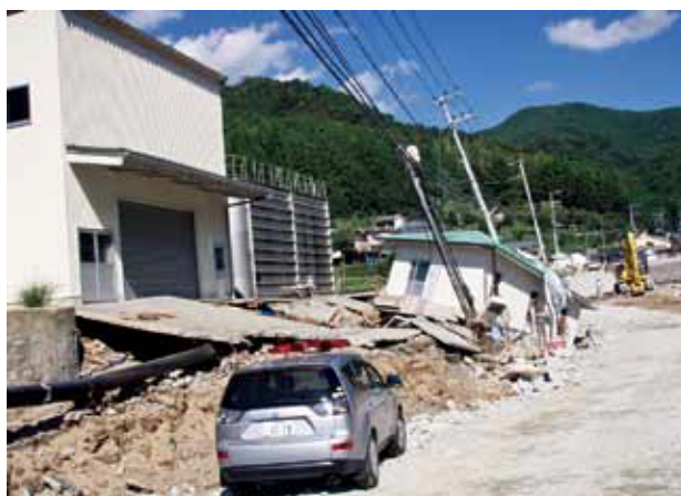
【浄水施設の被災状況(熊野市)】
