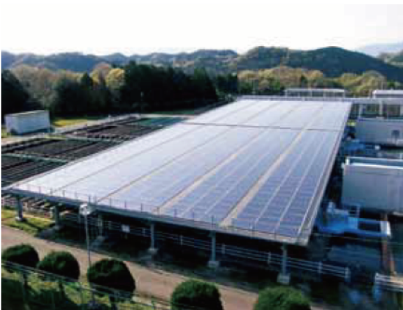
【太陽光発電設備(高野浄水場)】
