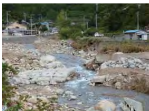
頭首工の流失
