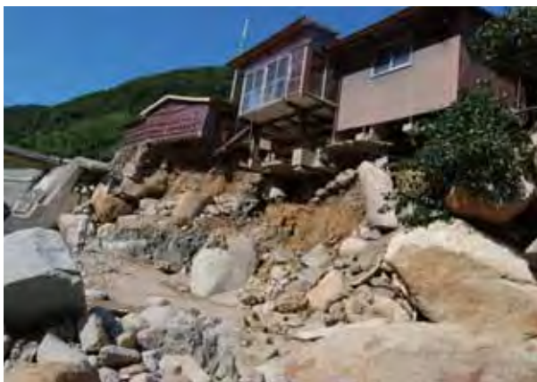
井戸川護岸の欠壊（熊野市）
