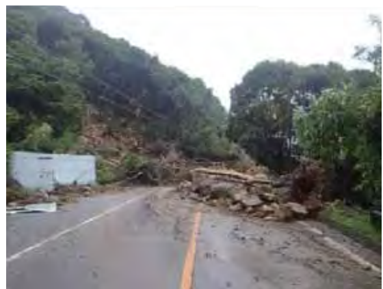
鶴殿熊野線法面崩落(紀宝町)
