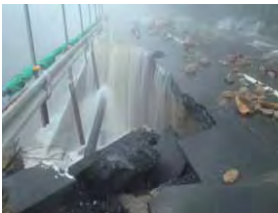
国道42号路肩欠損(熊野市)
