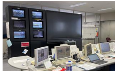
改良予定の施設 （統括監視制御設備）
