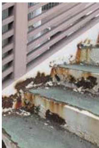
【横断歩道橋の老朽化事例】
